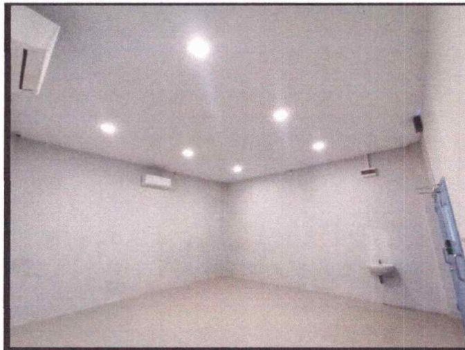
Ruang Biorepository dilengkapi AC & CCTV
